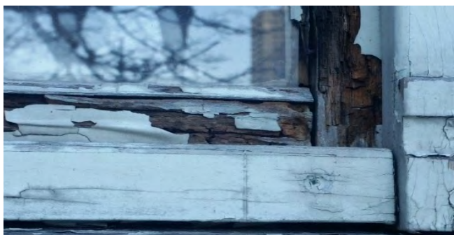
写真_3 腐ってしまった窓枠
