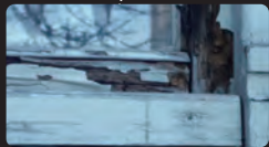
ガラスを止めるための小さな部材が腐ってしまっている
